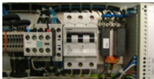
Sekundär säkring isoleringstransformator 3-polig C16A
