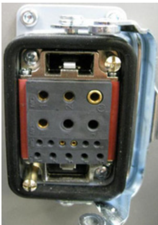
cos100710 uttag i manöverpanelen för omvandlare, drivning och lyftmotor
